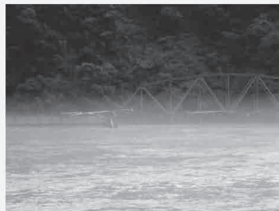
《被災直後》 第8只見川橋りょう部
