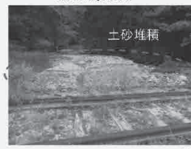
沢からの土砂堆積、土砂流入 (深沢橋りょう)
