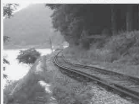
盛土地滑りによる線路沈下
