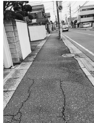
斜めに切り下げられて歩きにくく、危険な歩道。
